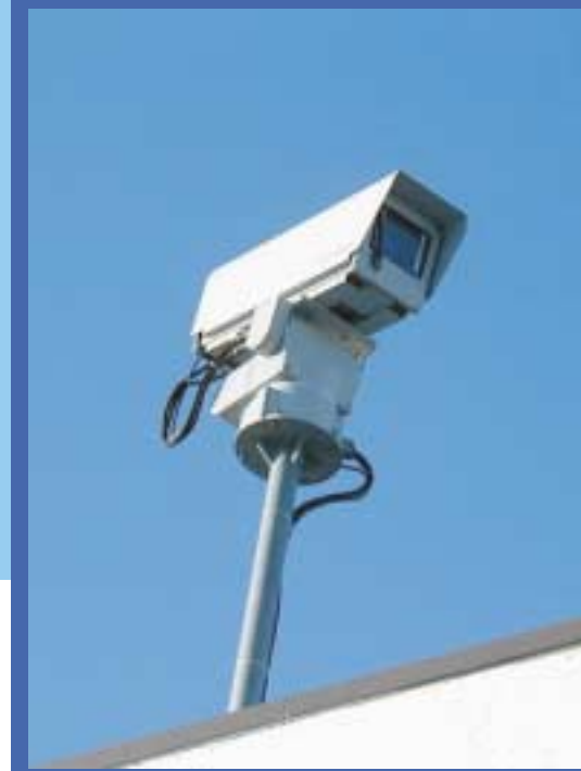
環境監視カメラ Surveillance Camera
